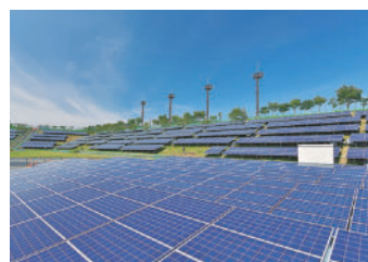
谷戸沢メガソーラー施設
