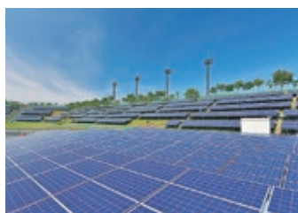
谷戸沢メガソーラー施設
