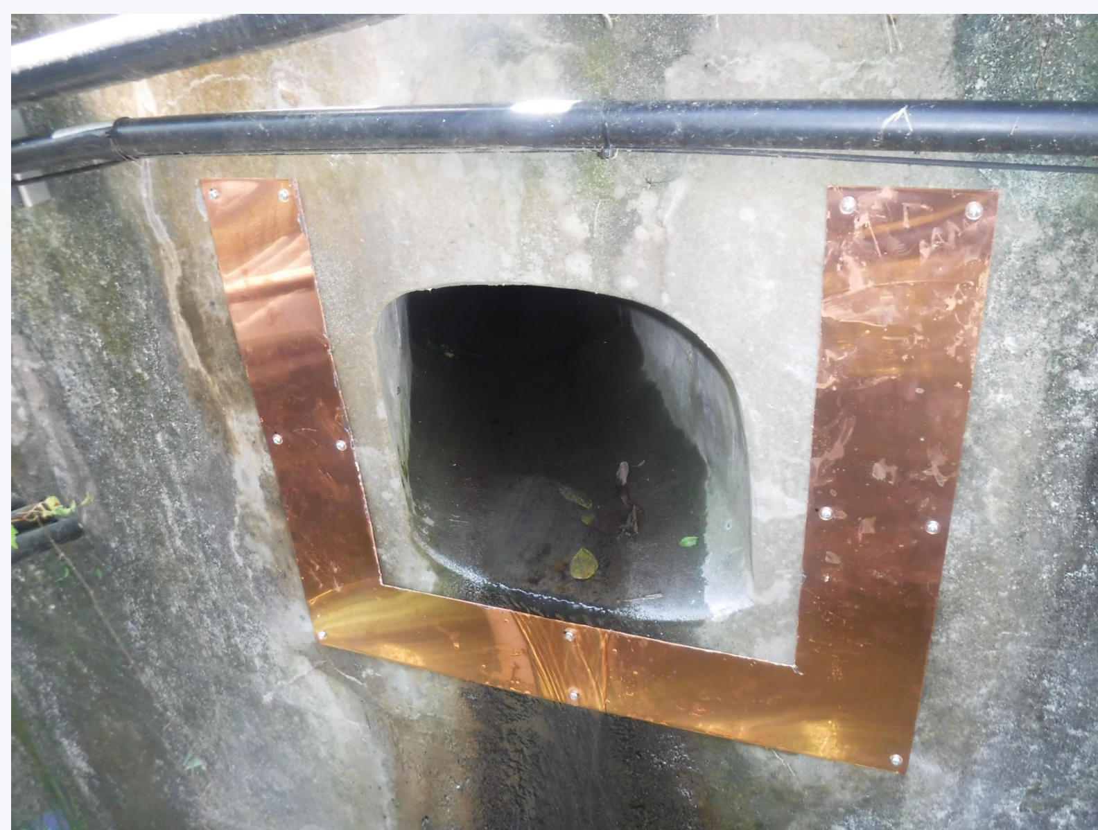
▲アメリカザリガニの侵入を防ぐための銅板の設置。滑るため登攀できなくなる。
