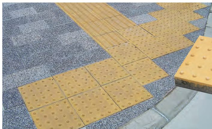
歩道で使われるブロック
