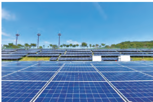
谷戸沢処分場 太陽光発電施設
