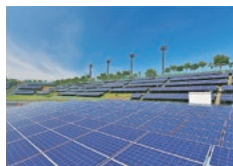
谷戸沢メガソーラー施設
