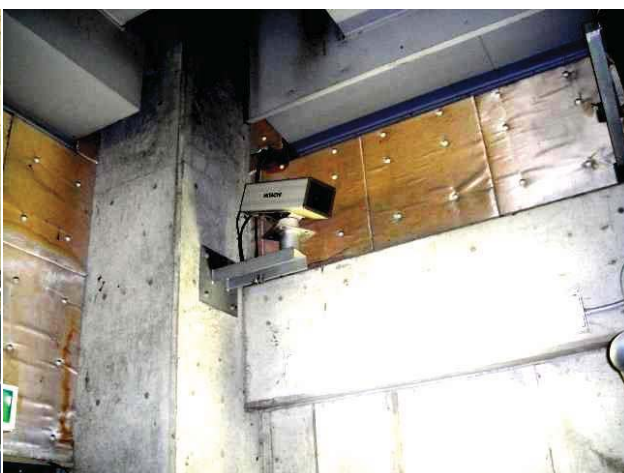
監視カメラの設置状況
