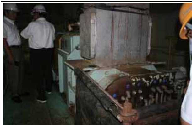
飛灰が固化処理され、装置から排出
