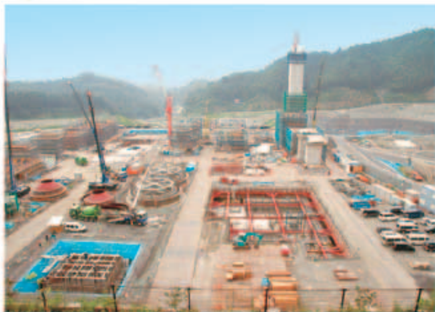
建設が進められているエコセメント化施設は、平成18年4月から稼働開始予定。
